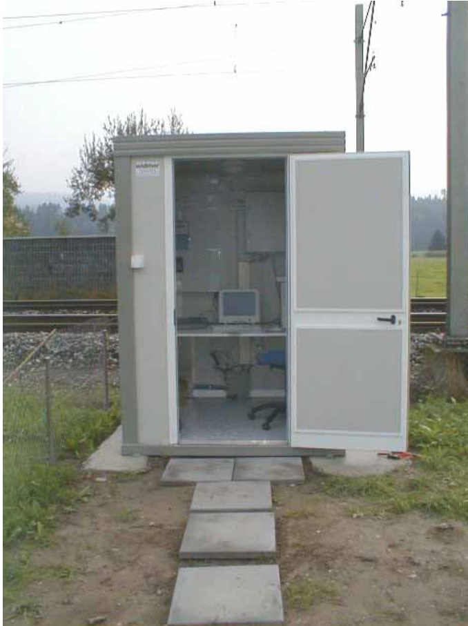
Klimatisierter Messcontainer mit PC und Steuerungselektronik
